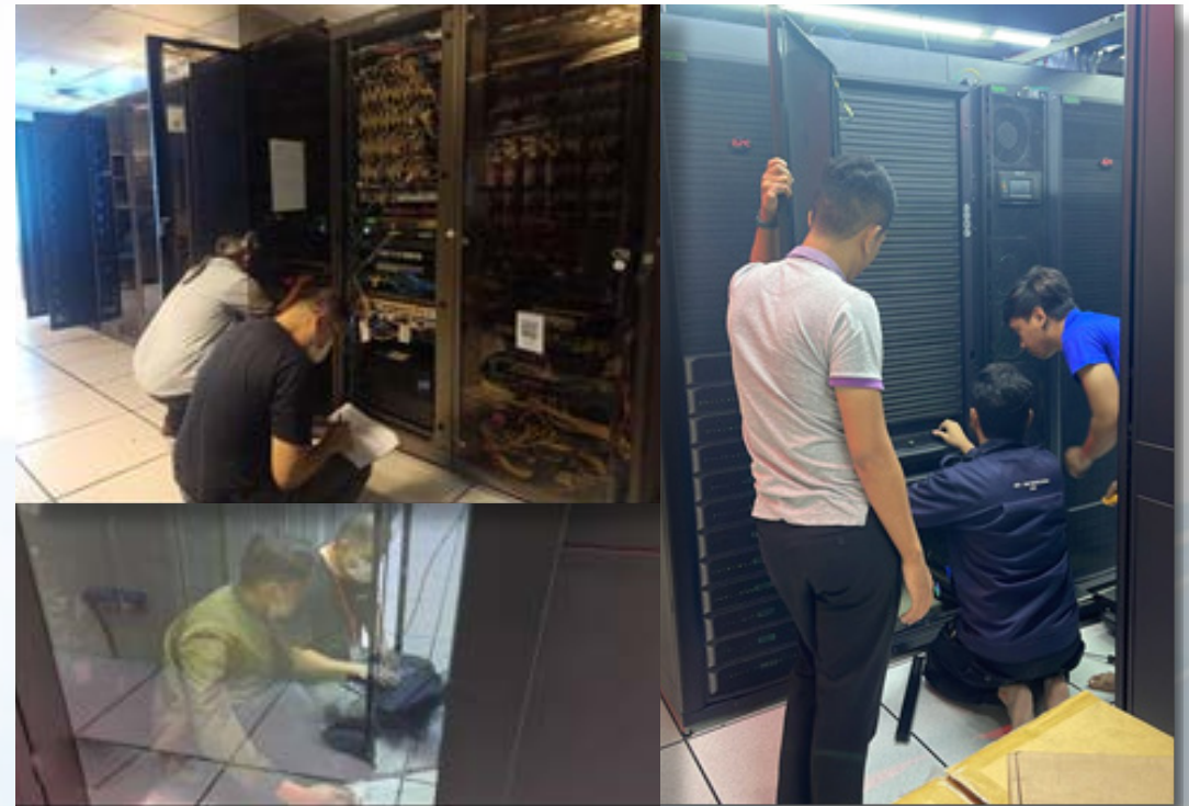
Kerja-kerja pemasangan dan konfigurasi data di DRC PHN
